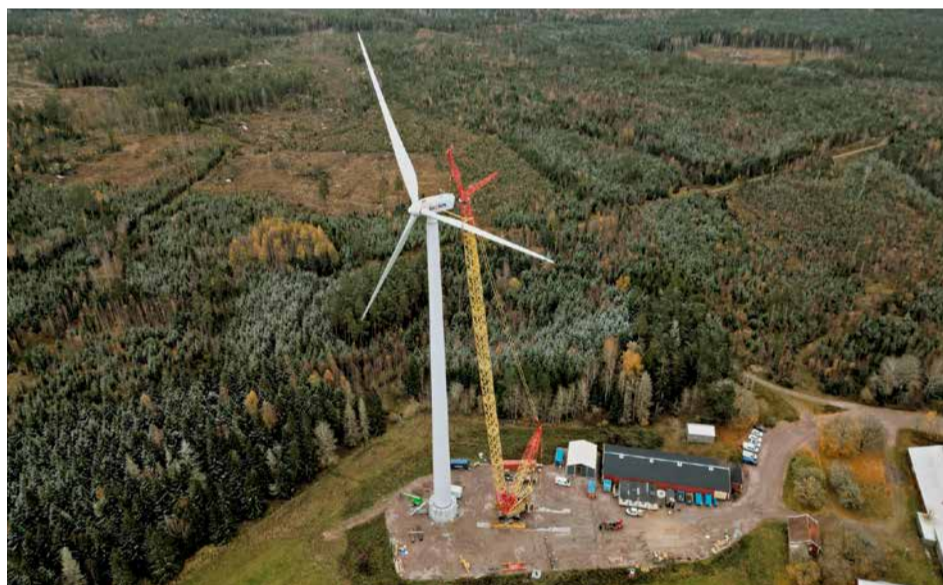
130 Kilometer östlich vom schwedischen Göteborg: Bauarbeiten am bisher „höchsten Windrad der Welt“.
